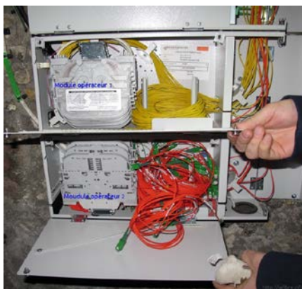
Figure 3 : Etiquetage des boites et des câbles de points de mutualisation
